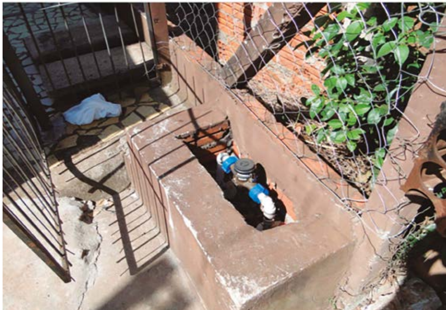
FIGURA 2: MEDIDOR DE CONSUMO INDICATIVO DA EXISTÊNCIA DE SISTEMA DE ABASTECIMENTO DE ÁGUA (REDE) 6
