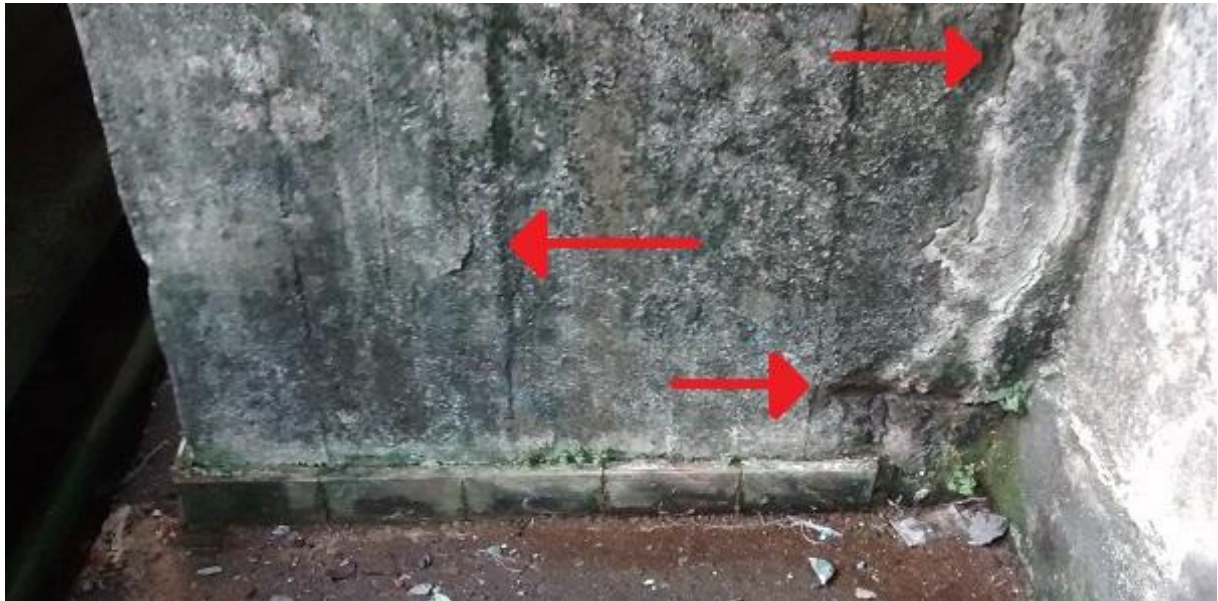
Fig. 4: Detalhe da base do pilar P2 com indicações das patologias.
