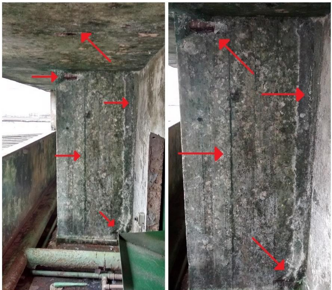
Fig. 3: Face direita do pilar P2 com identificação das patologias.
