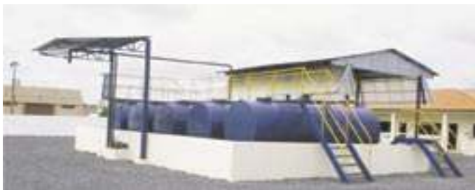
Figura 5 – Centros de coleta (Depósitos/Tancagens Provisórios).
