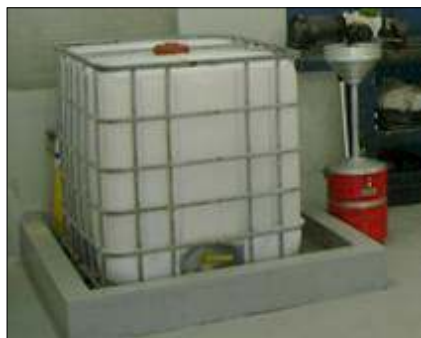
"Container" em bacia de contenção
