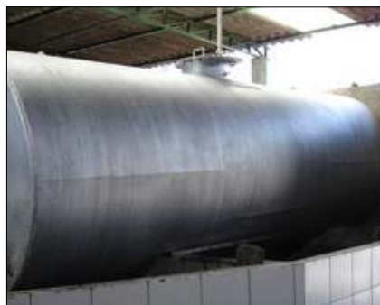
Tanque horizontal em bacia de contenção
