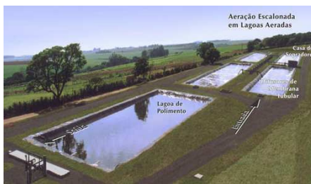
Estação de Tratamento de Efluentes de Unidade de Rerrefino (Cortesia: LWART)
