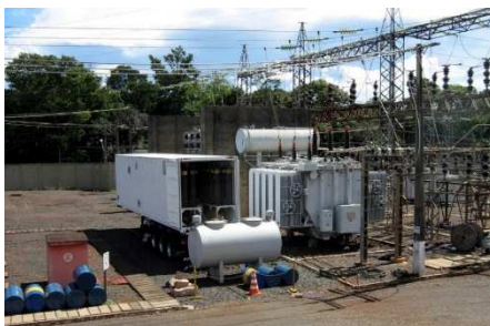
Unidade móvel de tratamento de óleos isolantes montada em uma carreta. (foto: COPEL)
