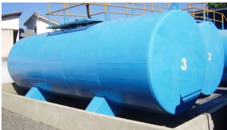
Detalhe dos tanques na bacia de contenção em uma base de armazenamento de pequeno porte. (Foto: SINDIREFINO)
